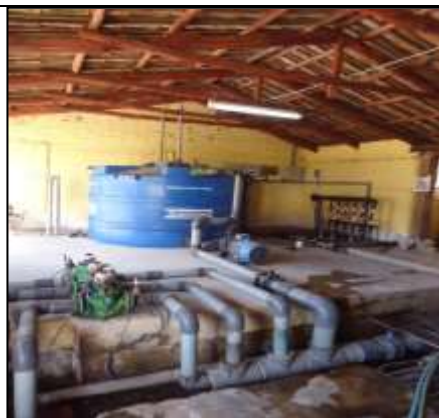
Fotografía 11: Caseta de Riego
