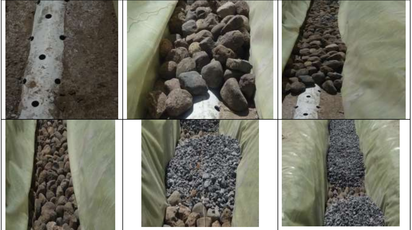
Fotografía 32: Sistema de Filtrado posterior al pozo séptico
